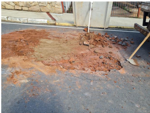
Foto 02: Com o corte feito pela Copasa foi possível ver que sob o asfalto não existe nenhum tipo de base e/ou sub base. O asfalto foi aplicado sobre o solo existente.
