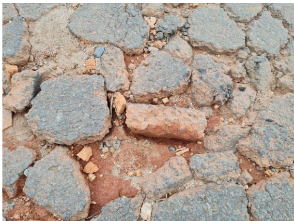
Foto 50: Detalhe de buraco e asfalto totalmente danificado.
