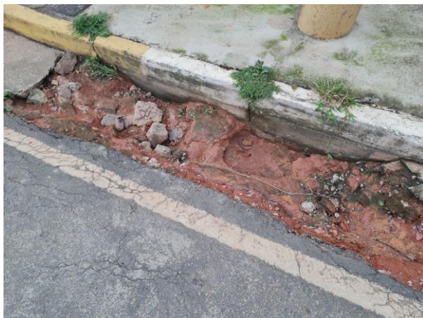
Foto 86: Detalhe da sarjeta danificada. Não existe base sob a sarjeta.
