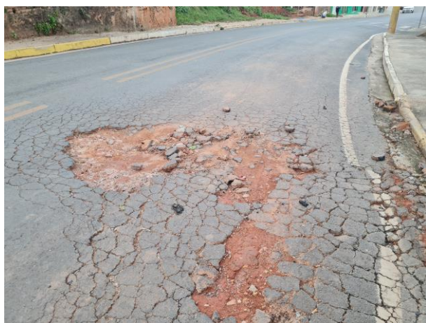
Foto 78: Detalhe de buraco e asfalto totalmente danificado. Não existe base sob o asfalto. Camada de asfalto de 2,0cm.
