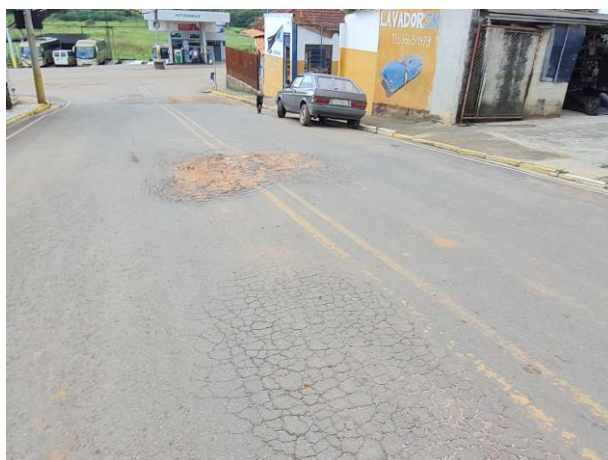
Foto 63: Em toda a extensão do asfalto há trincas e buracos. O asfalto encontra-se totalmente danificado.
