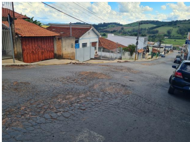
Foto 06: Em toda a extensão do asfalto há trincas e buracos. O asfalto encontra-se totalmente danificado.
