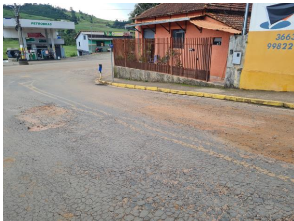
Foto 72: Em toda a extensão do asfalto há trincas e buracos. O asfalto encontra-se totalmente danificado.
