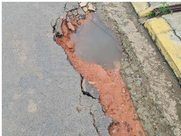
Foto 52: Detalhe de buraco junto à sarjeta.
