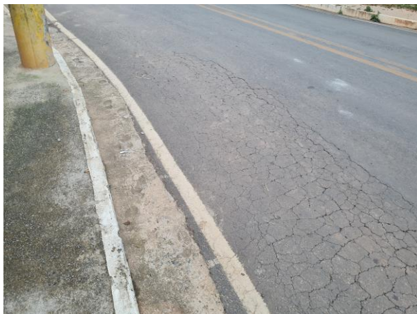
Foto 80: Detalhe de asfalto danificado.
