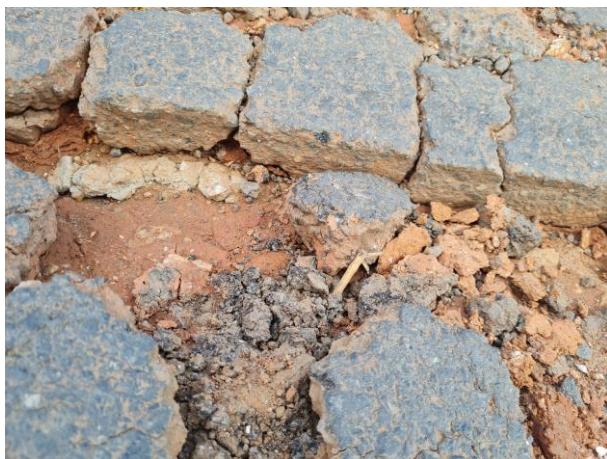
Foto 19: Detalhe do asfalto danificado. Nas bordas da pista, onde a camada é mais espessa, verificamos uma espessura de 3,5cm.
