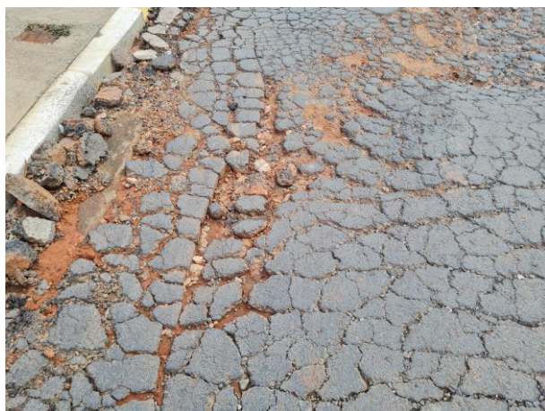
Foto 17: Detalhe do asfalto totalmente danificado junto à canaleta de drenagem.
