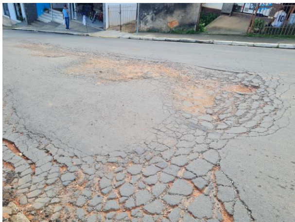
Foto 28: Em toda a extensão do asfalto há trincas e buracos. Alguns locais nem tem asfalto. O asfalto encontra-se totalmente danificado.
