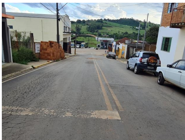
Foto 59: Em toda a extensão do asfalto há trincas e buracos. O asfalto encontra-se totalmente danificado.
