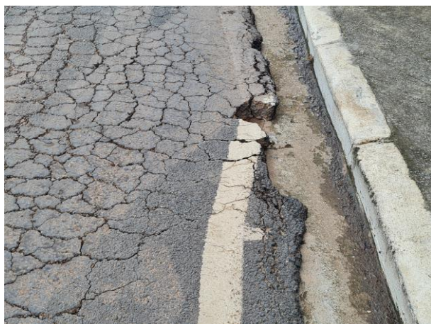
Foto 55: Detalhe, asfalto danificado e com buraco.
