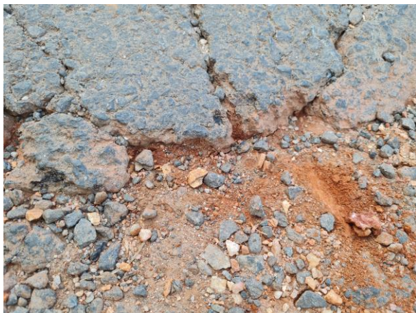
Foto 38: Detalhe de buraco no meio da rua. Camada asfáltica de 1,5cm.
