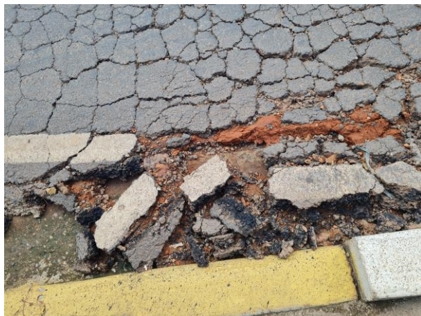
Foto 26: Detalhe da canaleta danificada. Não foi executada base sob a canaleta/sarjeta.
