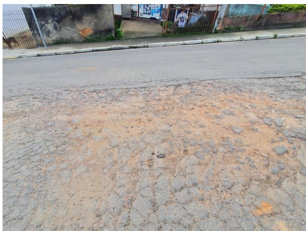
Foto 29: Em toda a extensão do asfalto há trincas e buracos. O asfalto encontra-se totalmente danificado. Detalhe de local sem asfalto. No meio da via, foi verificada uma espessura de 1,5cm de camada asfáltica.
