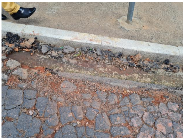
Foto 18: Detalhe do asfalto totalmente danificado junto à canaleta de drenagem.
