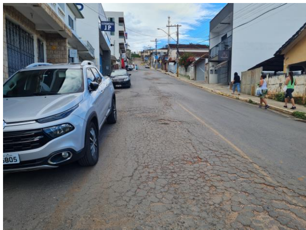
Foto 36: Em toda a extensão do asfalto há trincas e buracos. O asfalto encontra-se totalmente danificado.
