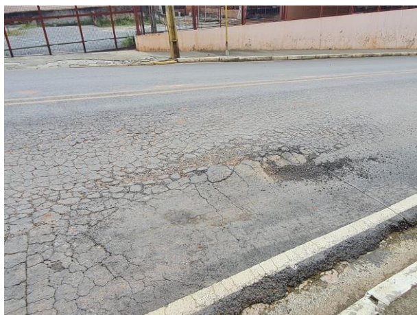
Foto 57: Asfalto danificado e com buraco.
