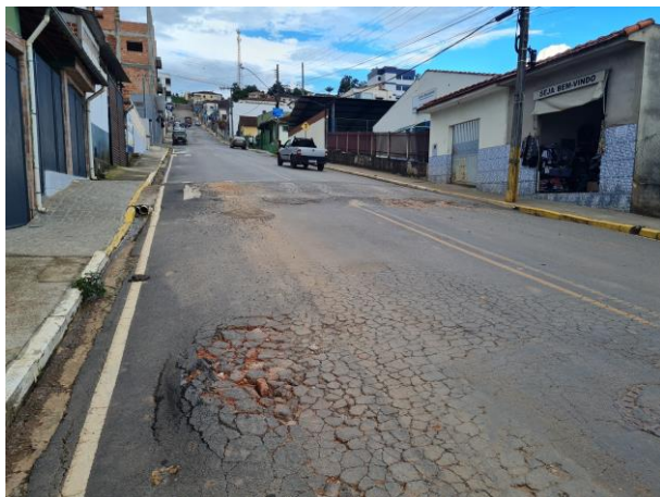
Foto 44: Em toda a extensão do asfalto há trincas e buracos. O asfalto encontra-se totalmente danificado.
