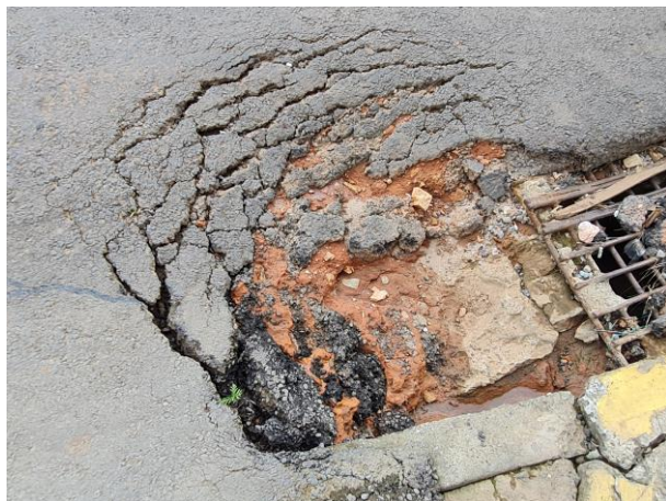
Foto 58: Asfalto danificado e com buraco junto à drenagem.
