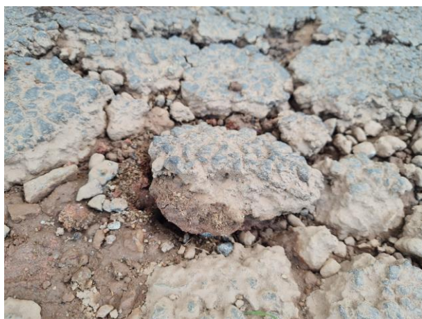
Foto 47: Detalhe de buraco e asfalto totalmente danificado.
