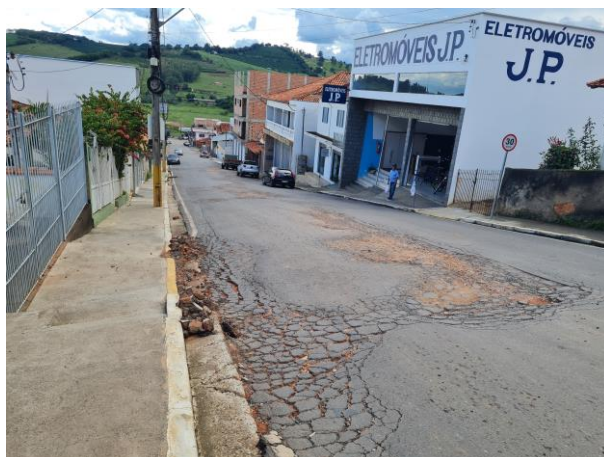
Foto 24: Em toda a extensão do asfalto há trincas e buracos. O asfalto encontra-se totalmente danificado.
