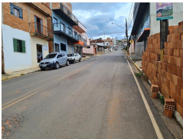
Foto 67: Em toda a extensão do asfalto há trincas e buracos. O asfalto encontra-se totalmente danificado.
