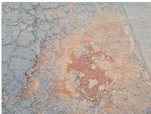
Foto 37: Detalhe de buraco no meio da rua.
