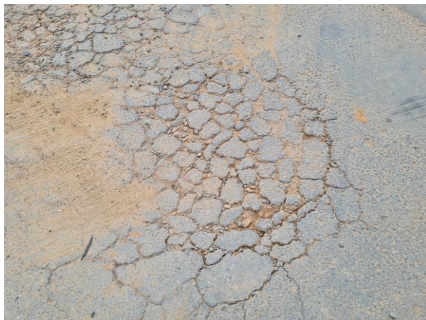
Foto 74: Detalhe de buraco e asfalto totalmente danificado.
