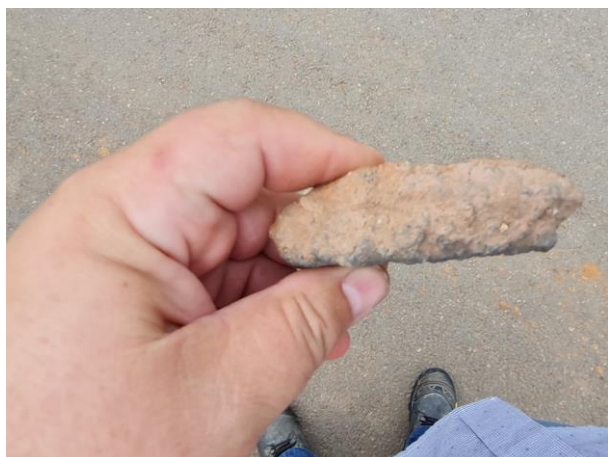
Foto 65: Espessura da camada do asfalto no local do buraco, 2,0cm.
