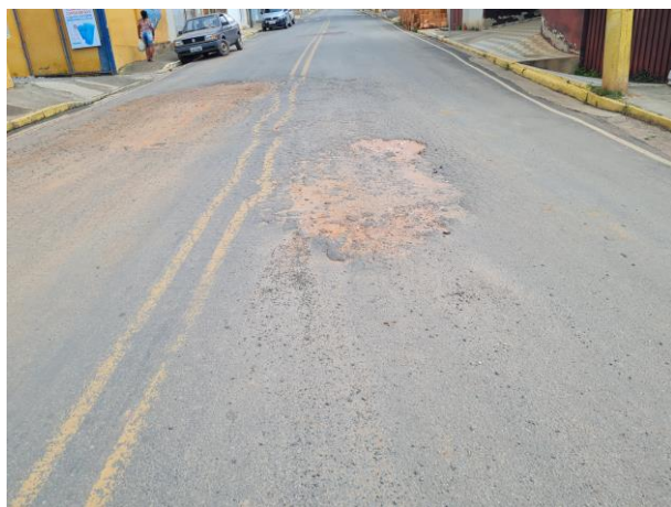
Foto 73: Em toda a extensão do asfalto há trincas e buracos. O asfalto encontra-se totalmente danificado.
