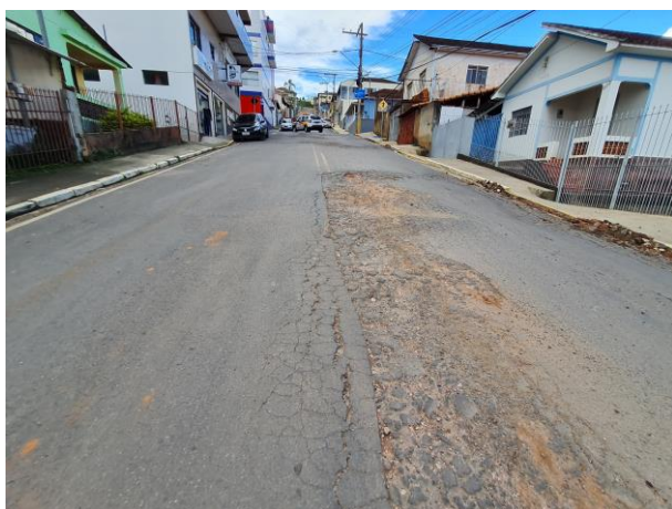
Foto 31: Em toda a extensão do asfalto há trincas e buracos. O asfalto encontra-se totalmente danificado.
