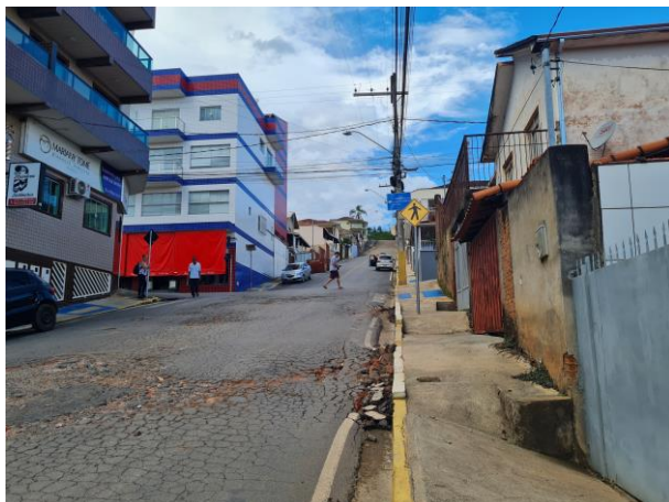
Foto 23: Em toda a extensão do asfalto há trincas e buracos. O asfalto encontra-se totalmente danificado.
