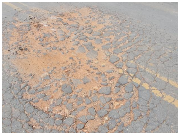
Foto 64: Detalhe, asfalto danificado e com buraco.
