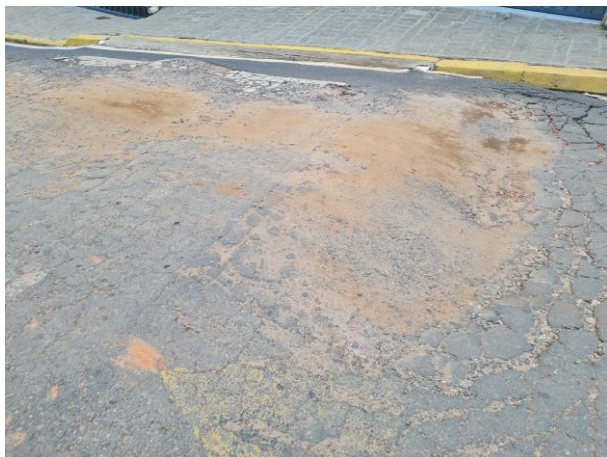
Foto 42: Detalhe de buraco e asfalto totalmente danificado.
