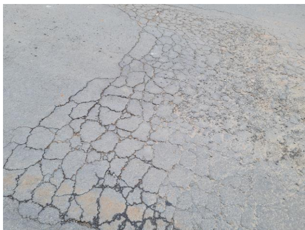
Foto 41: Detalhe do asfalto totalmente danificado.
