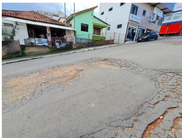
Foto 27: Em toda a extensão do asfalto há trincas e buracos. O asfalto encontra-se totalmente danificado.
