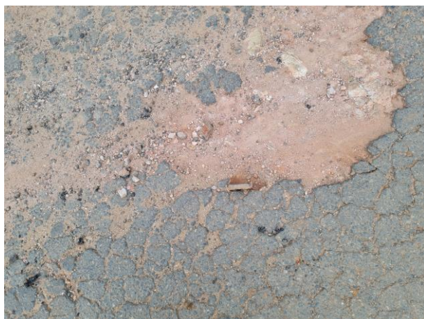
Foto 75: Detalhe de buraco e asfalto totalmente danificado.
