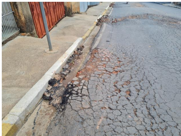
Foto 16: Asfalto totalmente danificado junto à canaleta de drenagem superficial.
