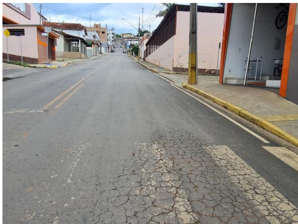
Foto 60: Em toda a extensão do asfalto há trincas e buracos. O asfalto encontra-se totalmente danificado.
