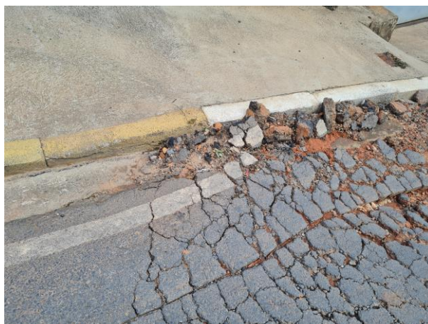
Foto 25: Detalhe do asfalto danificado e a canaleta/sarjeta também danificada.
