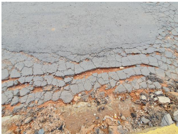
Foto 30: Detalhe do asfalto totalmente danificado junto à sarjeta.
