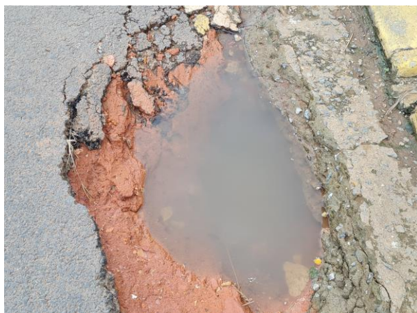
Foto 53: Detalhe de buraco junto à sarjeta. Claramente perceptível que não há base sob a camada asfáltica.
