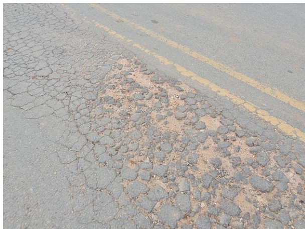
Foto 62: Detalhe, asfalto danificado e com buraco.
