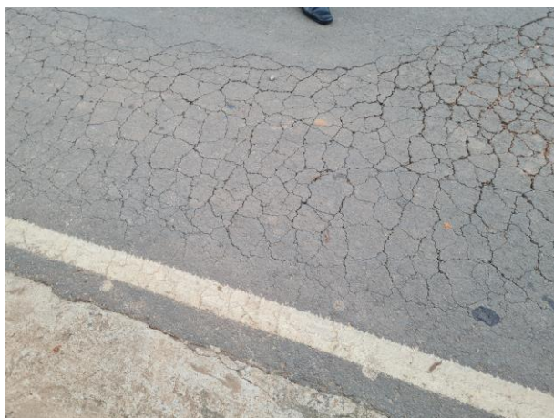
Foto 79: Detalhe de asfalto totalmente danificado.
