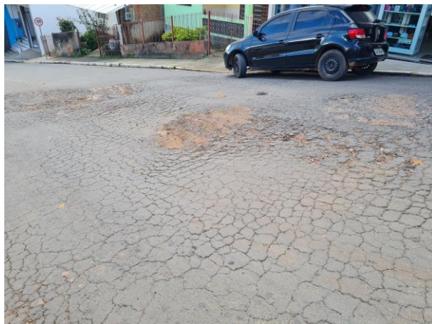
Foto 21: Em toda a extensão do asfalto há trincas e buracos. O asfalto encontra-se totalmente danificado.
