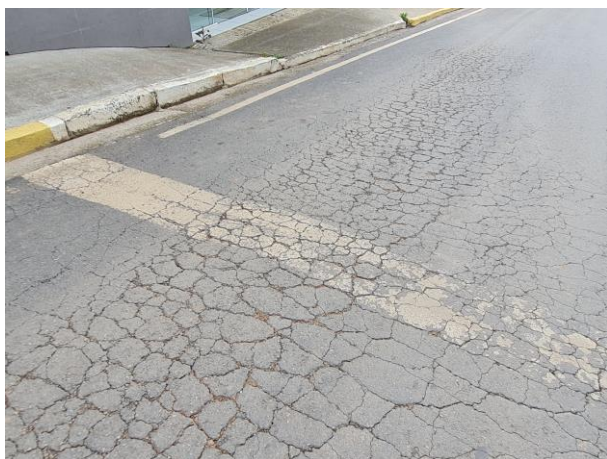
Foto 61: Detalhe, asfalto danificado.
