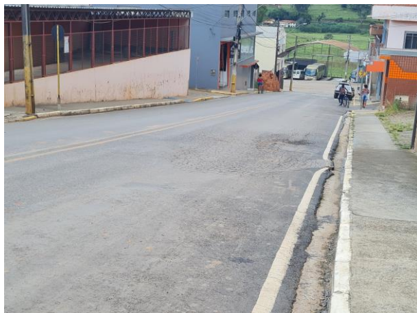
Foto 54: Asfalto danificado e com buraco.
