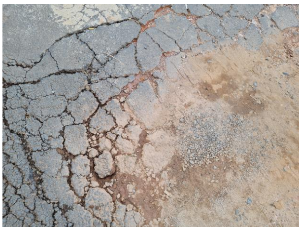
Foto 45: Detalhe de buraco e asfalto totalmente danificado.
