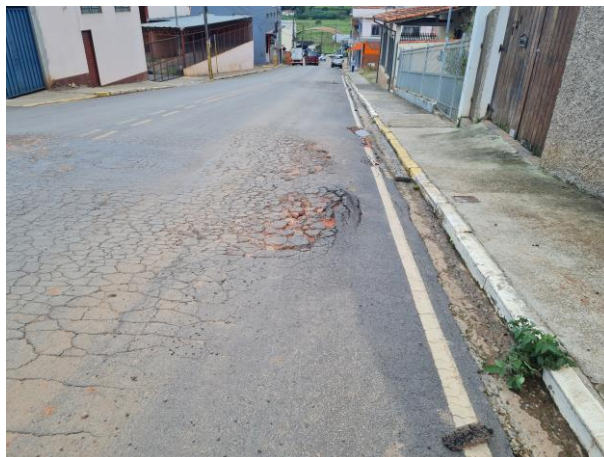
Foto 48: Em toda a extensão do asfalto há trincas e buracos. O asfalto encontra-se totalmente danificado.
