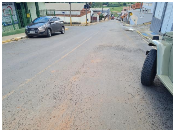
Foto 40: Em toda a extensão do asfalto há trincas e buracos. O asfalto encontra-se totalmente danificado.
