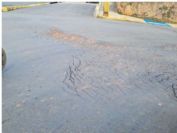
Foto 12: Detalhes das trincas e buracos, alguns locais nem tem asfalto mais.
