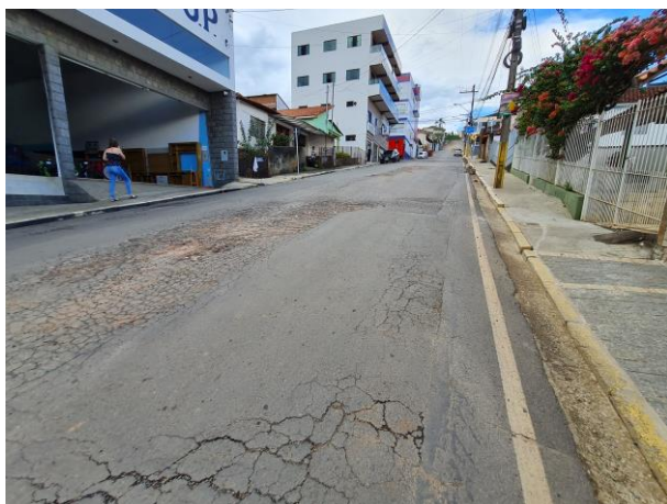
Foto 35: Em toda a extensão do asfalto há trincas e buracos. O asfalto encontra-se totalmente danificado.
