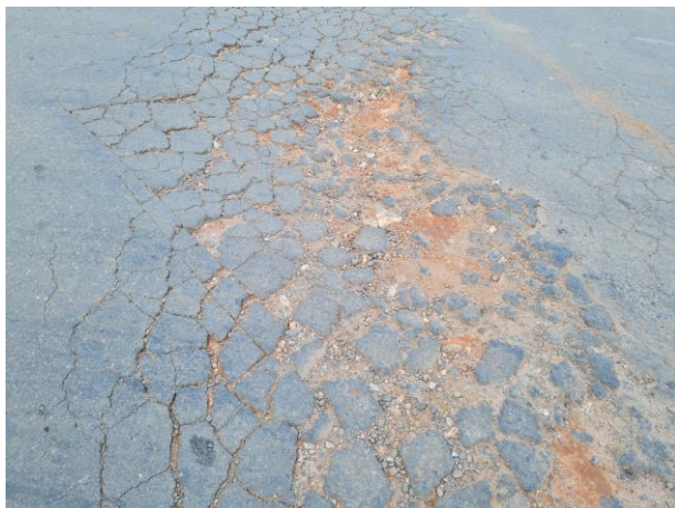
Foto 11: Detalhes das trincas e buracos, alguns locais nem tem asfalto mais.
