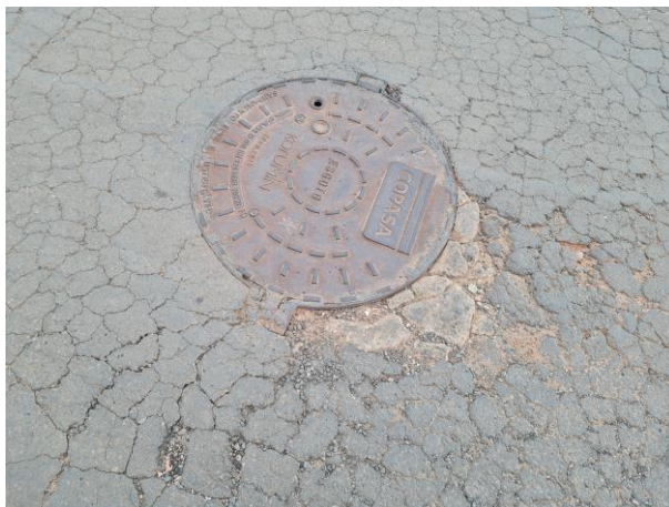
Foto 94: Detalhe de asfalto totalmente danificado.
