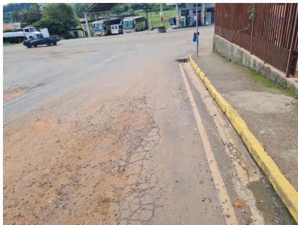
Foto 70: Detalhe de buraco bastante grande, cruzamento com a Avenida Presidente Tancredo Neves, entrada da cidade.
