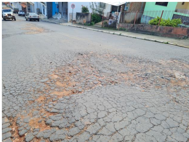
Foto 20: Em toda a extensão do asfalto há trincas e buracos. O asfalto encontra-se totalmente danificado.
