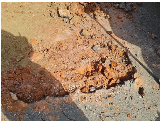
Foto 03: Detalhe do solo sob o asfalto, não foi executada base para a aplicação da camada asfáltica.
