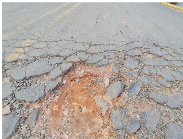
Foto 33: Detalhe de buraco no meio da via. Espessura da camada asfáltica de 1,5cm sem a existência de base e/ou sub-base.
