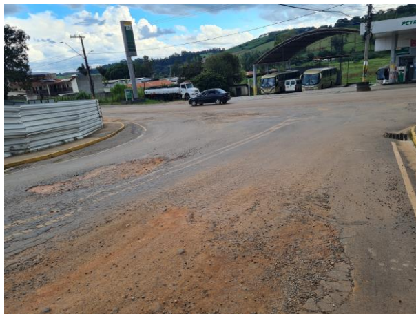
Foto 71: Detalhe de buracos bastante grandes, cruzamento com a Avenida Presidente Tancredo Neves, entrada da cidade.
