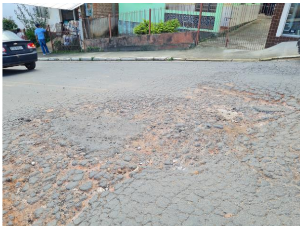
Foto 22: Em toda a extensão do asfalto há trincas e buracos. O asfalto encontra-se totalmente danificado.
