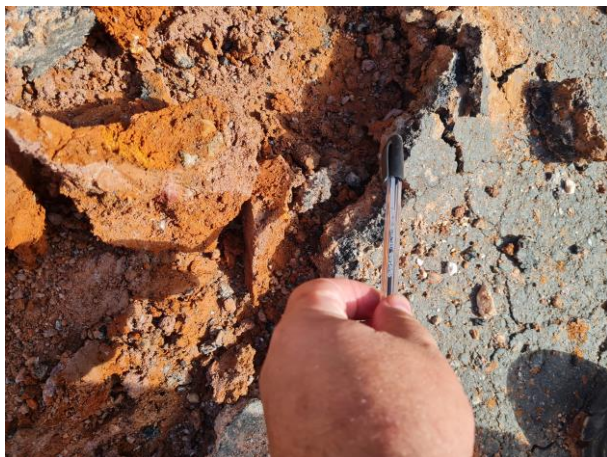
Foto 04: No local foi possível verificar que a camada asfáltica existente possui apenas 3 cm de espessura.
