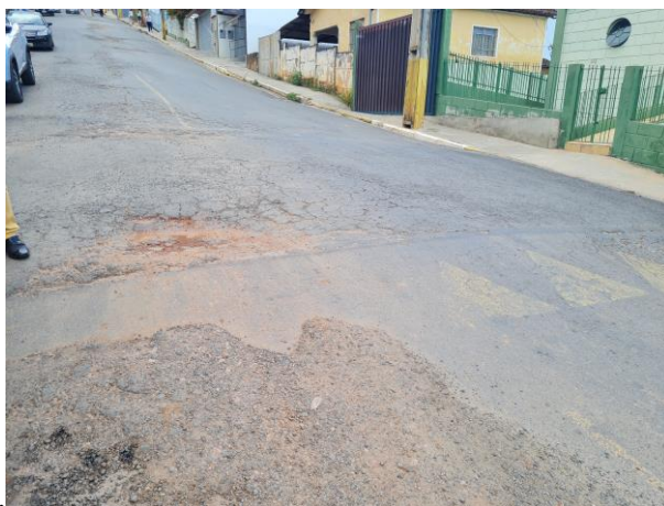
Foto 39: Em toda a extensão do asfalto há trincas e buracos. O asfalto encontra-se totalmente danificado.
