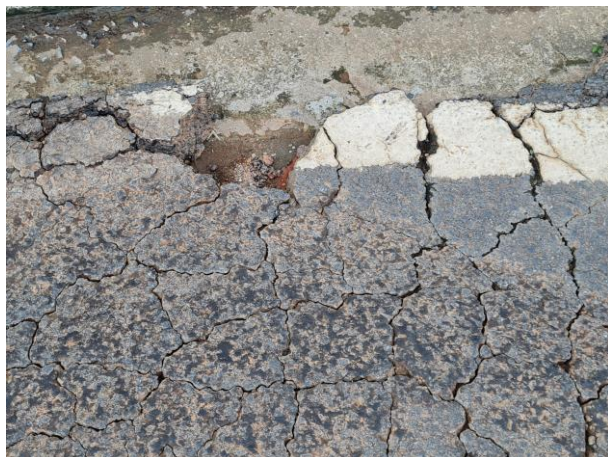
Foto 56: Detalhe, asfalto danificado e com buraco.
