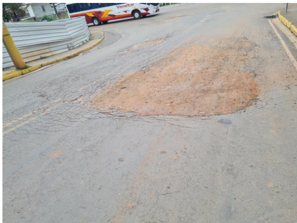
Foto 69: Grande buraco, sem a presença de asfalto.
