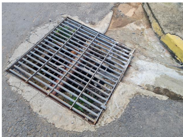
Foto 15: Detalhe da drenagem e asfalto trincado ao redor.
