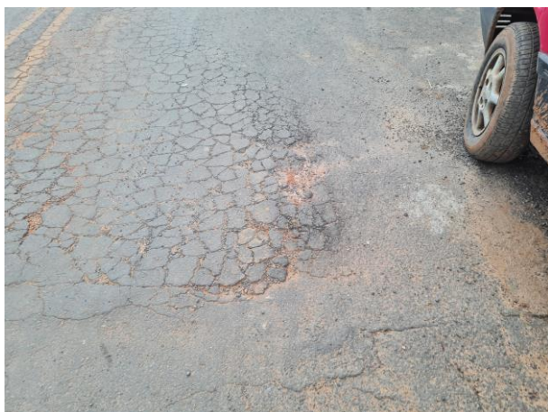
Foto 93: Detalhe de asfalto totalmente danificado.
