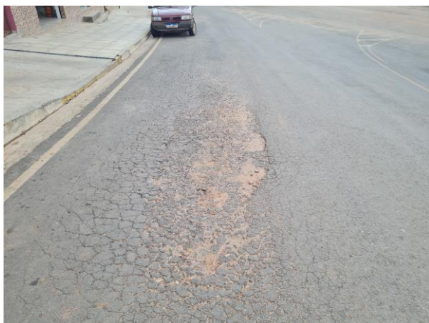
Foto 83: Detalhe de buraco e asfalto totalmente danificado.
