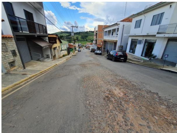
Foto 34: Em toda a extensão do asfalto há trincas e buracos. O asfalto encontra-se totalmente danificado.
