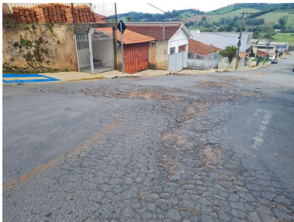
Foto 10: Em toda a extensão do asfalto há trincas e buracos. O asfalto encontra-se totalmente danificado.
