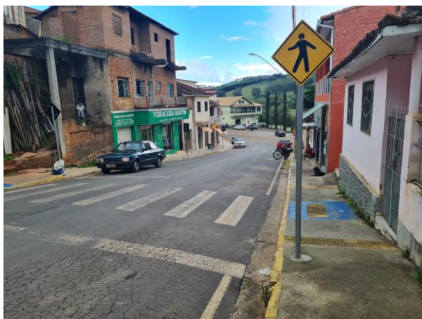
Foto 81: Em toda a extensão do asfalto há trincas e buracos. O asfalto encontra-se totalmente danificado.
