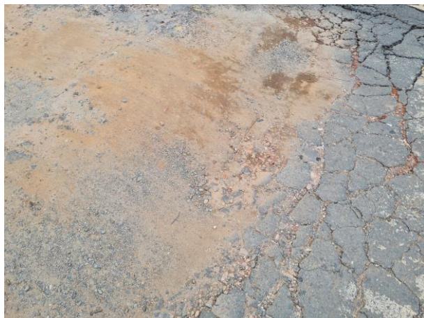
Foto 46: Detalhe de buraco e asfalto totalmente danificado.
