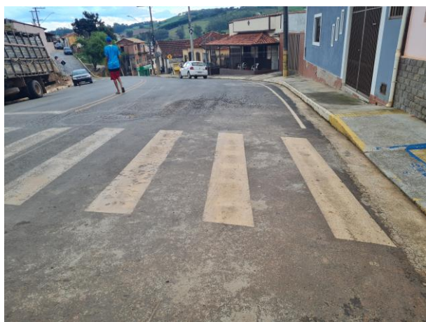
Foto 91: Em toda a extensão do asfalto há trincas e buracos. O asfalto encontra-se totalmente danificado.
