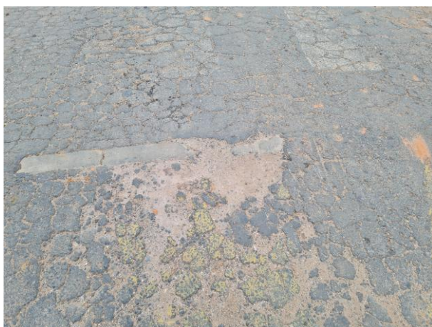
Foto 43: Detalhe de buraco e asfalto totalmente danificado.
