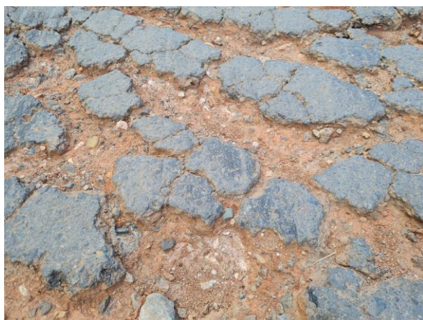
Foto 13: Detalhe do asfalto totalmente danificado.
