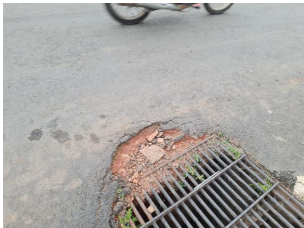
Foto 90: Detalhe de buraco junto à drenagem.
