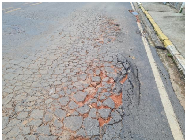
Foto 49: Detalhe de buraco e asfalto totalmente danificado.
