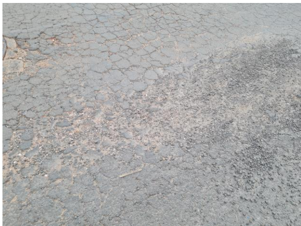
Foto 92: Detalhe de asfalto totalmente danificado.
