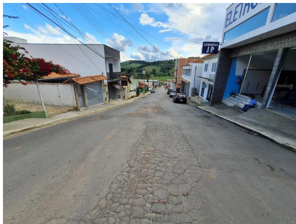
Foto 32: Em toda a extensão do asfalto há trincas e buracos. O asfalto encontra-se totalmente danificado.
