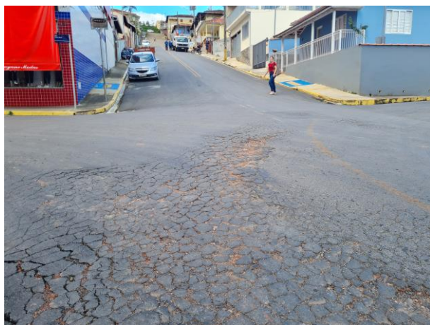
Foto 07: Em toda a extensão do asfalto há trincas e buracos. O asfalto encontra-se totalmente danificado.
